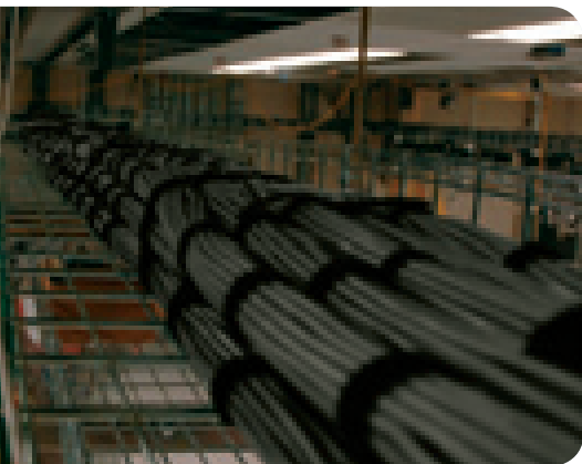
ニューメキシコのデータセンター
